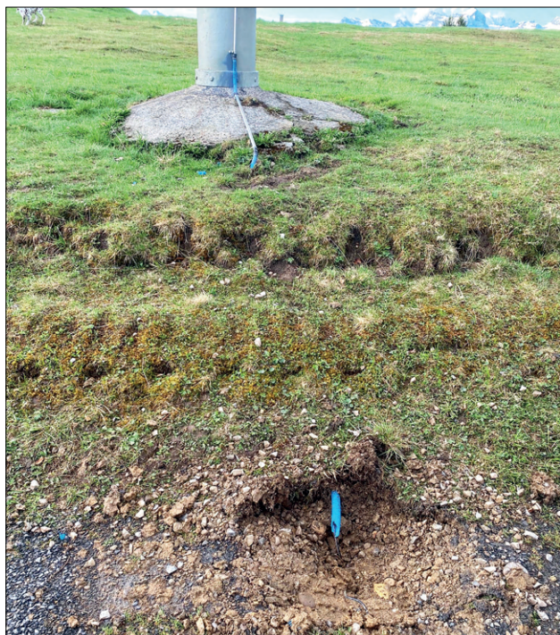
Bild 1: Blitzeinschlag 8.5.2026 ins Koax-Kabel
